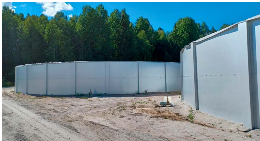
Siirrettävä lietesäiliö on hyvä ratkaisu kierrätyslannoitteiden varastointiin ja se toimii hyvin myös etäsäiliönä pellon reunalle pystytettynä. Kuva rakennusvaiheesta.
