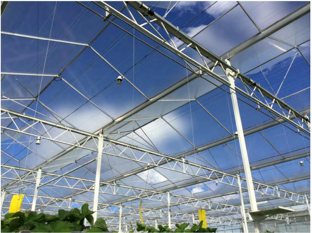
Kuva 15. Mansikkakasvihuoneiden rakenteissa käytetään diffuusiolasia, jonka ansiosta valoa ohjautuu huoneeseen enemmän
